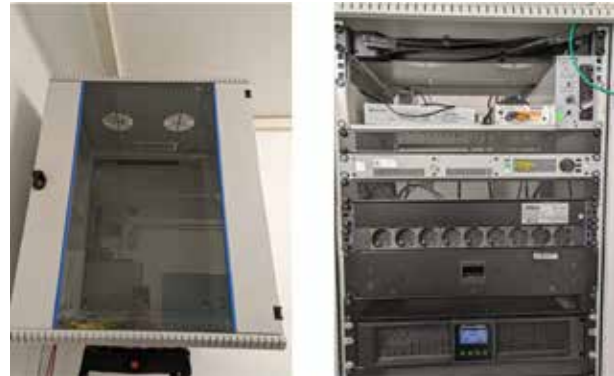
Neues Rack im Technikraum, rechts nach dem Einbau der Komponenten
